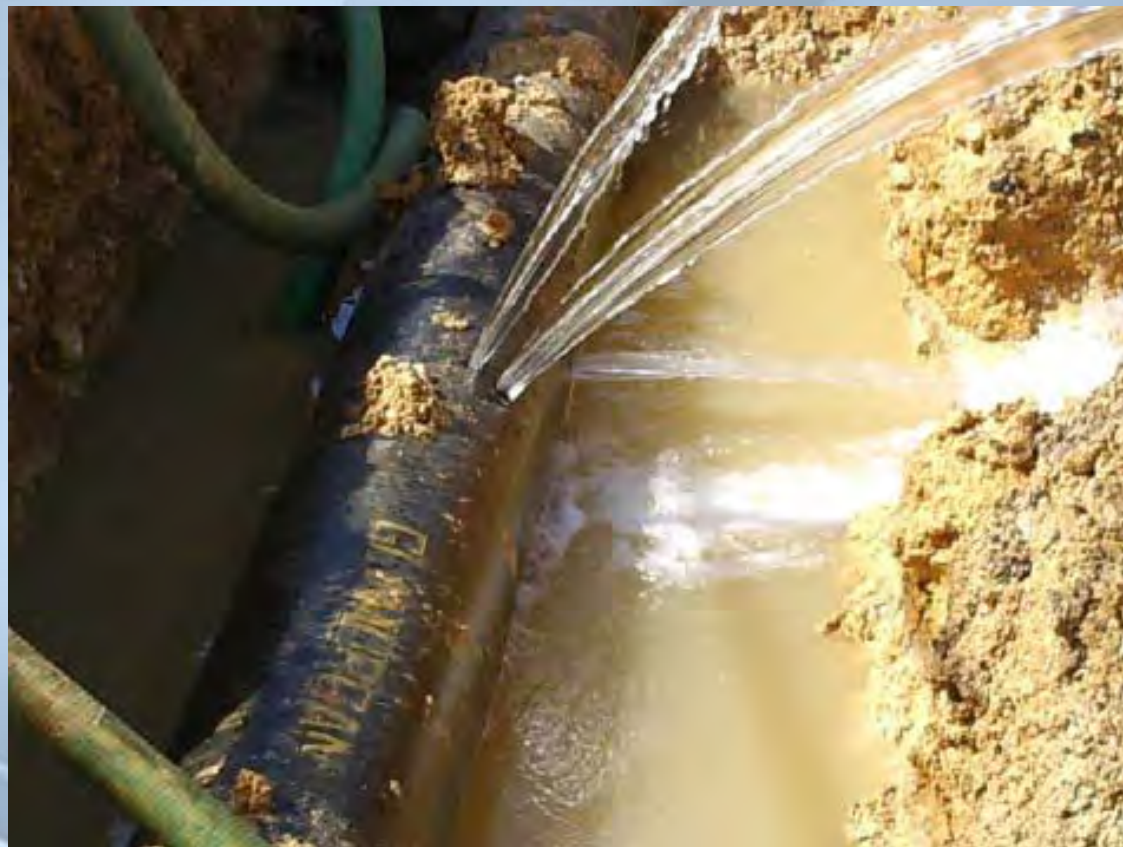
Perforacja ścianki rury z żeliwa sferoidalnego spowodowana korozją wżerową
