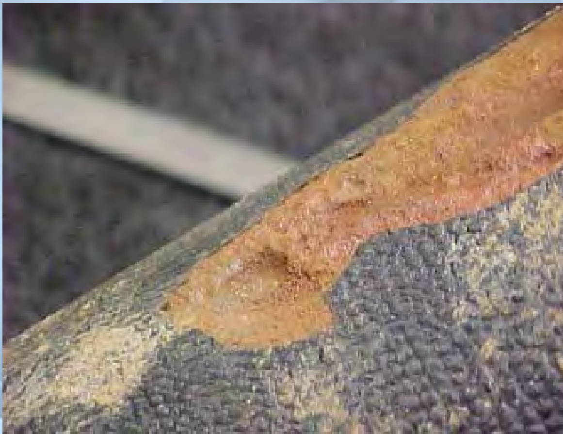
Korozja wżerowa rury z żeliwa sferoidalnego
