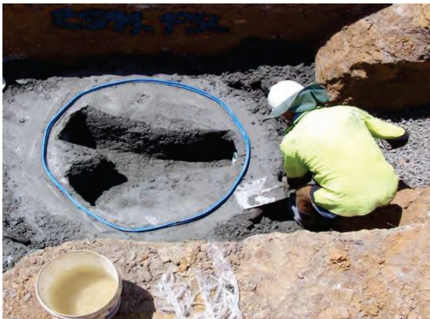
Zdjęcie 4. Uszczelnienie pomiędzy kinetą a trzonem studni betonowej
