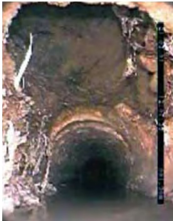
Duża pustka powietrzna nad wierzchołkiem uszkodzonego kanału
