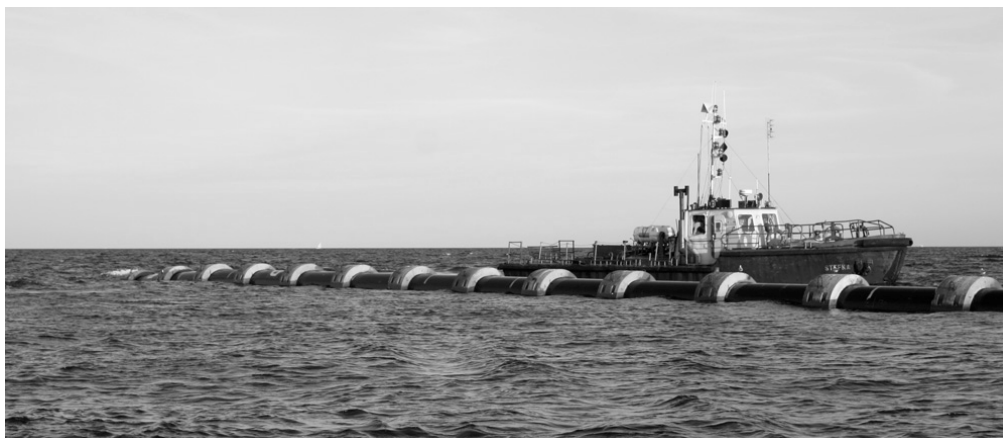
Fot. 4 Zatopienie kolektora PE
