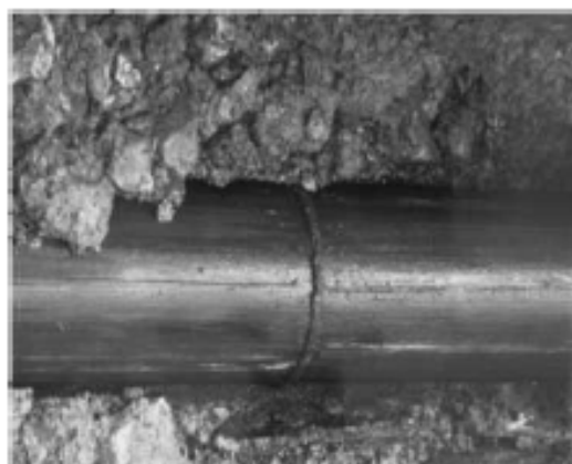
Rys. 8: uderzenia kamieni i zarysowania
